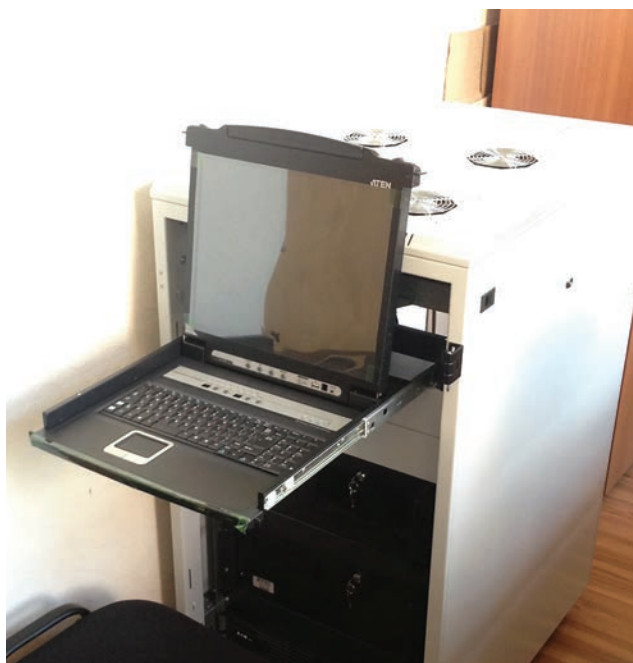
Рис. 2. Стойка локального управляющего сервера РТП
