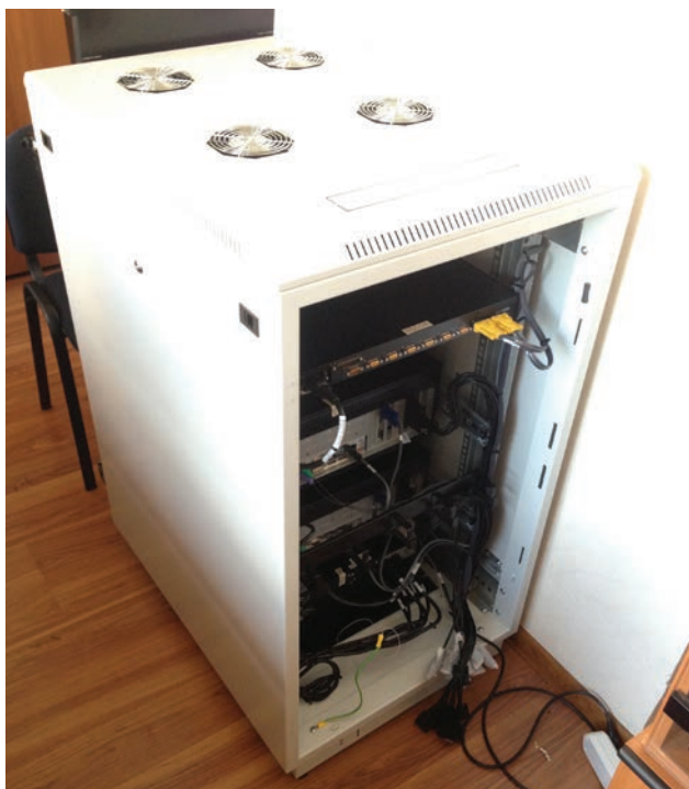
Рис. 3. Входы и выходы приборных интерфейсов для связи с оборудованием РТП (тыльная сторона стойки локального сервера управления, задняя крышка снята)
